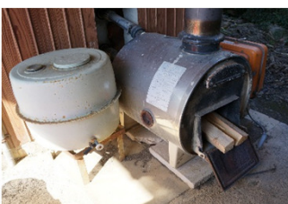
木材により風呂をわかす薪ボイラー
